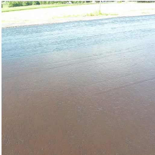
Abb. 17 Fläche mit gebrochenen Haftkleber und neu gespritzte Oberfläche.
