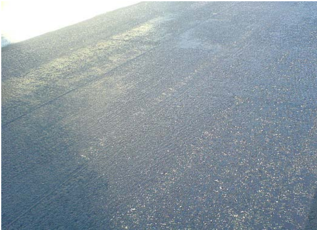
Abb. 31 Fräsfläche ist unter dem Haftkleber noch sichtbar.
