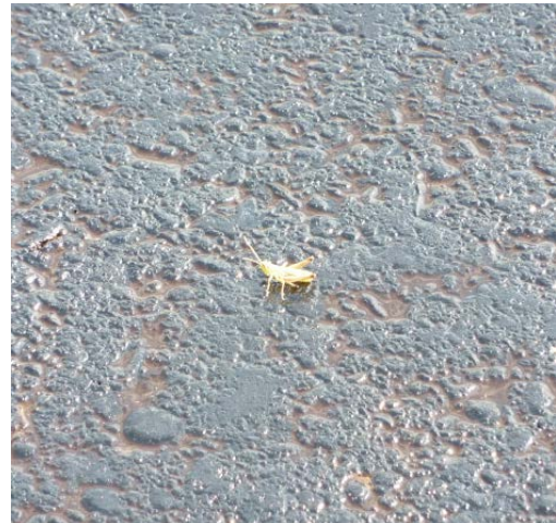
Abb. 18 Haftkleber teilweise gebrochen: In den Vertiefungen ist der Prozess des Brechens noch nicht abgeschlossen.
