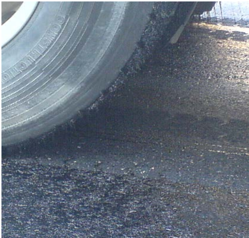
Abb. 37 Bitumenfäden am Reifen beim Einbau der Binderschicht.
