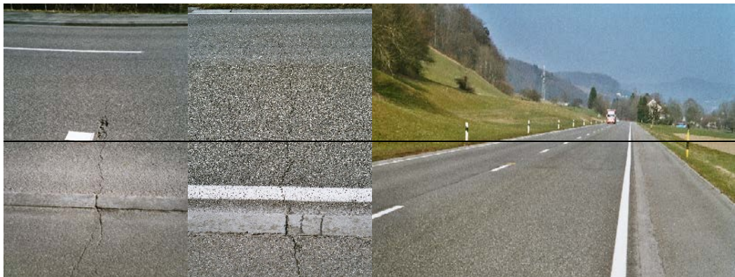
Abb. 5.1 Schadenbilder an der Hauensteinstrecke Beobachtungen:
